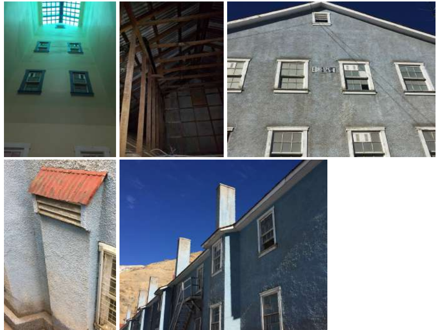
Imagen 5. Estrategia de autoventilación: Techo ventilado (imágenes superiores) y shafts (imágenes inferiores) (fuente: De las autoras, 2019).
